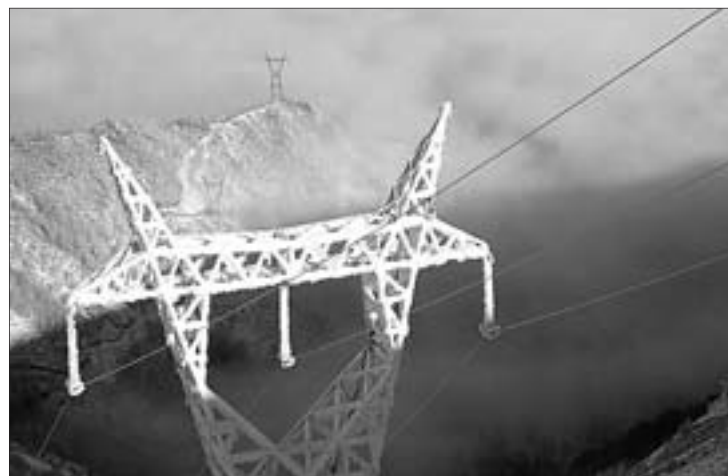
Tendido eléctrico propiedad de Red Eléctrica Española (REE).
